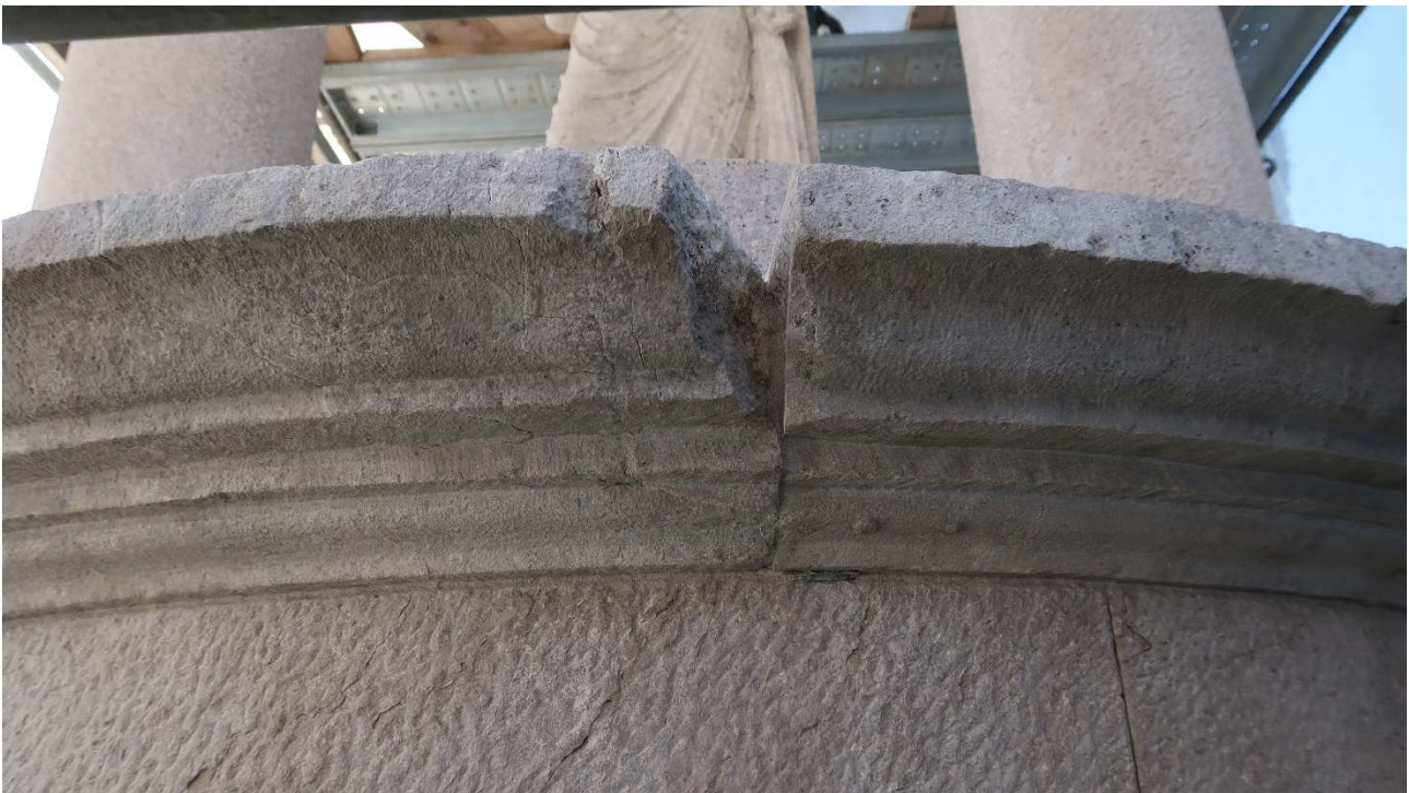
Foto 10. Particolare del cornicione del tamburo dopo l'intervento: - è stato rifinito il livello di pulitura - le fessurazioni sono state sigillate
