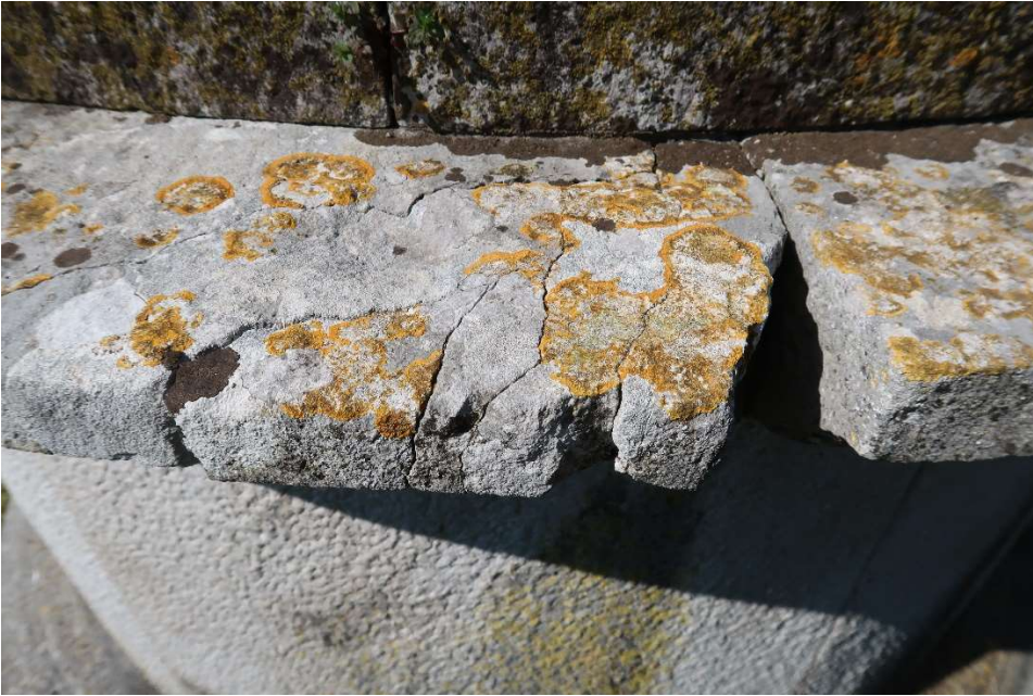
Foto 7. Particolare del cornicione del tamburo prima dell'intervento: le fessurazioni entrano nella profondità del blocco lapideo e hanno provocato il distacco di numerosi frammenti.
