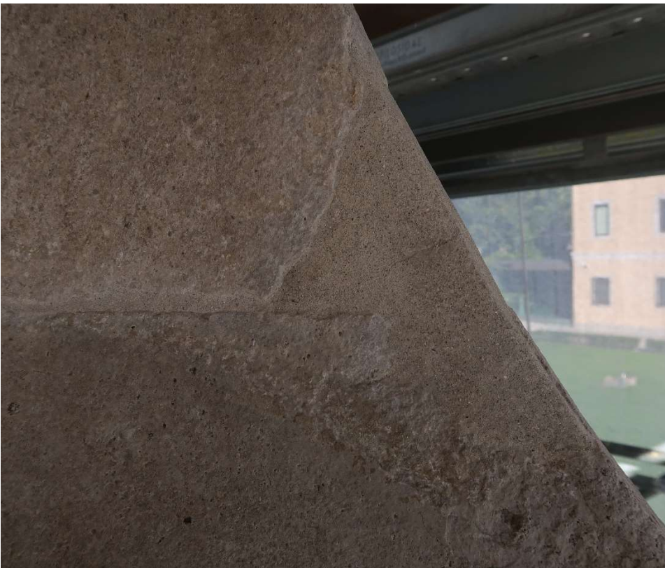
Foto 23. Lo stesso particolare dopo l'intervento con la nuova stuccatura in leggero sottolivello rispetto le superfici lapidee.
