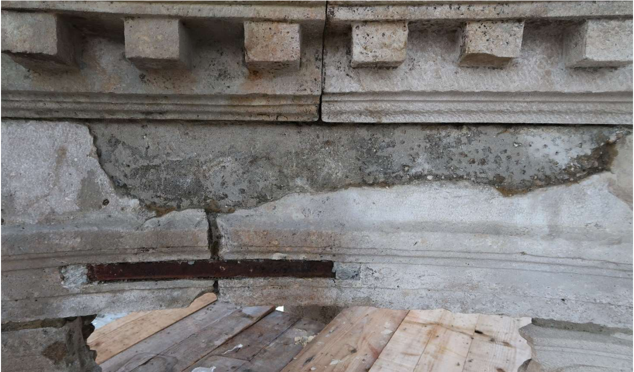
Foto 26. Particolare del lato nord dell'architrave triangolare dopo la pulitura: si nota la grande lacuna risarcita con stuccatura a base cementizia
