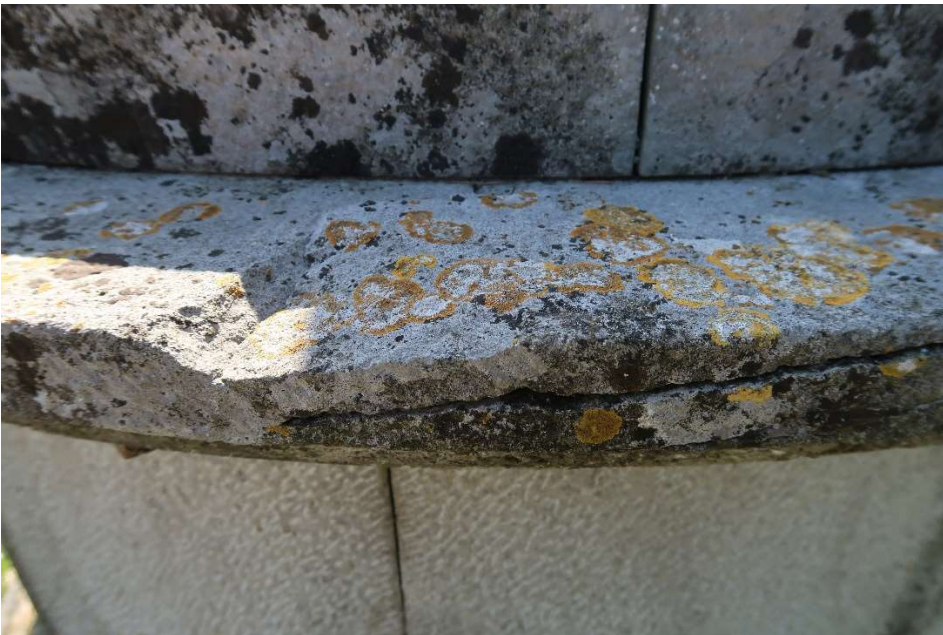
Foto 6. Particolare del cornicione del tamburo prima dell'intervento. Si nota la presenza dei vari tipi di licheni sia crostosi che endolitici e le numerose fessurazioni.
